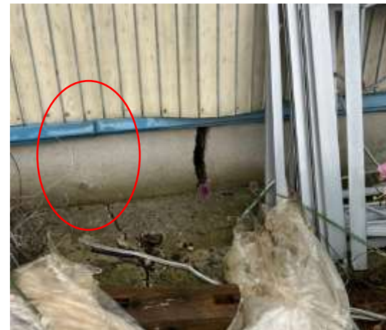
傾いた柱や地盤
