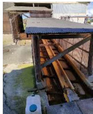
バンクリーナー通路のひび割れ
