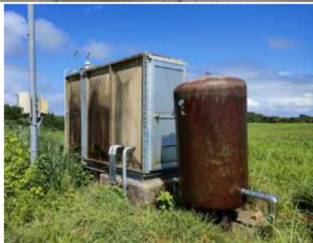
地下水汲上げポンプ・パイプ
