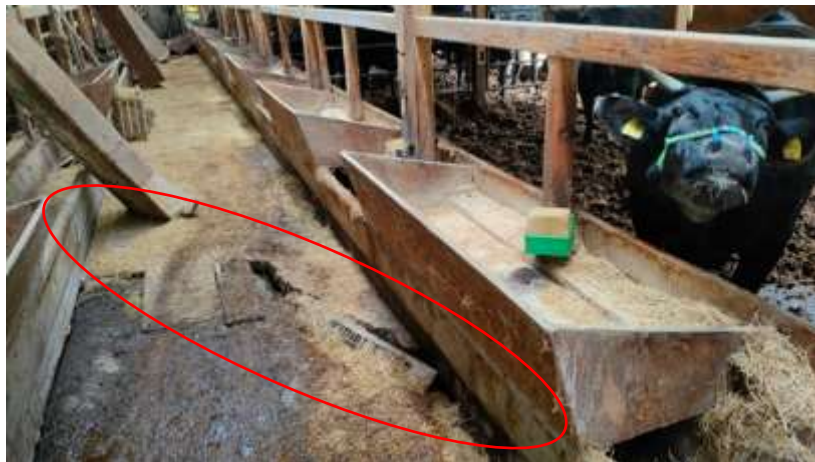
床などの亀裂
